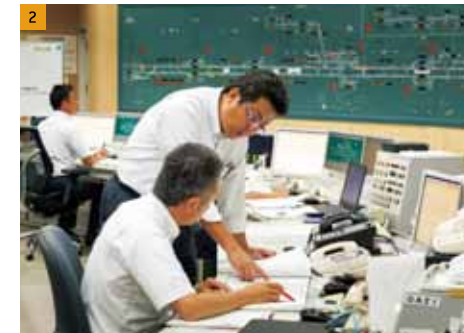
1 運行監視盤が壁一面に設置される運転指令所。緊急時 に備え、西鉄福岡(天神)駅や大橋駅など主要駅のカメラの 映像も流れています 2 個々の役割が明確に分かれている ため、各担当との綿密な打ち合わせも欠かせません 3 運行 監視盤には、5桁の数字とアルファベットで記された列車番号 が表示され、運行状況がひと目でわかります
